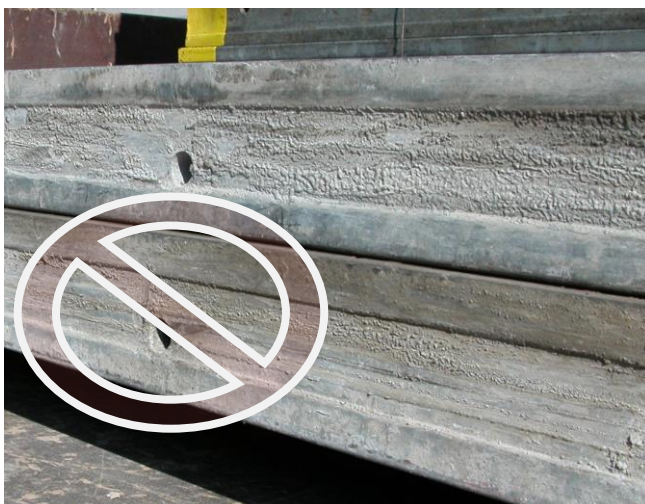
Slika 23: Primer ostanka betona na okvirju panela
