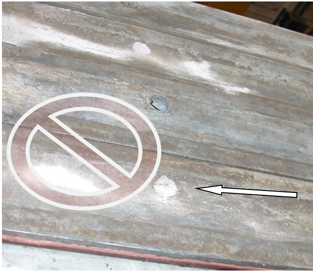
Slika 24: Primer ostanka betona na okvirju panela
