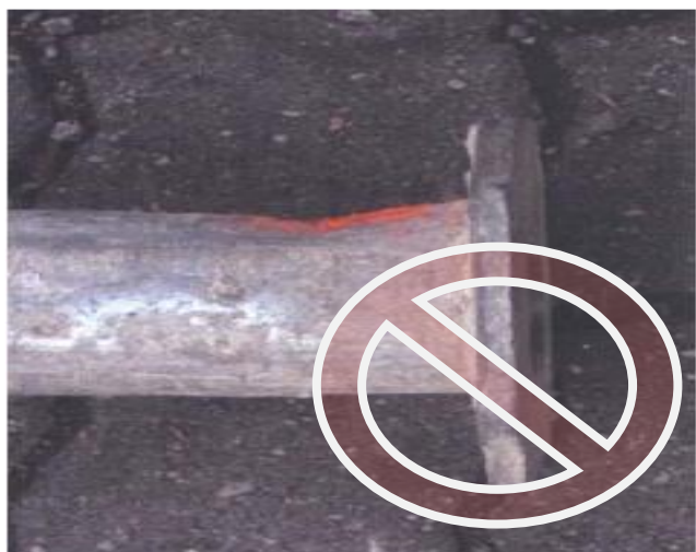
Slika 16: Primer udrtine na podporniku
