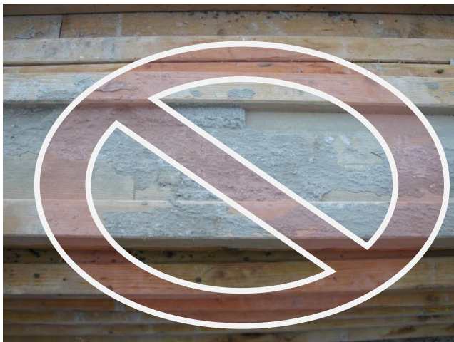
Slika 1: Primer ostanka betona na lesenem nosilcu
